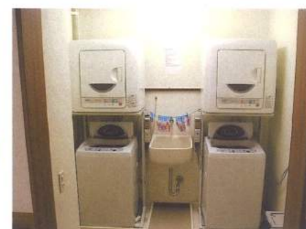
洗濯場(各階設置)
